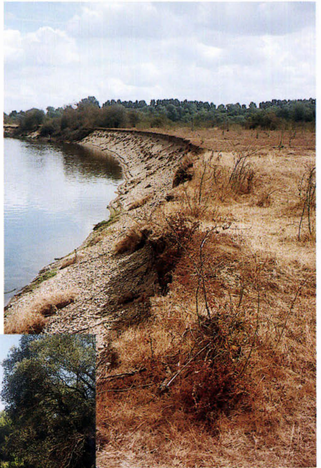
FIGUUR 9 Erosieve oever in overwegend niet-cohesief materiaal waarbij ondergraven blokken over de oeverwand schuiven (foto: Jurgen de Kramer, 1998).
